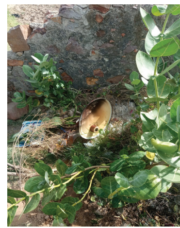
ट्रांसफार्मर को पोल से नीचे उतारकर सुनसान स्थान तक ले गए, जहां उसका कवर खोलकर अंदर का तांबा और तेल निकाल लिया गया। सुबह जब ग्रामीणों ने पोल पर ट्रांसफार्मर का ढक्कन लटका देखा और पास शमथान घाट में
